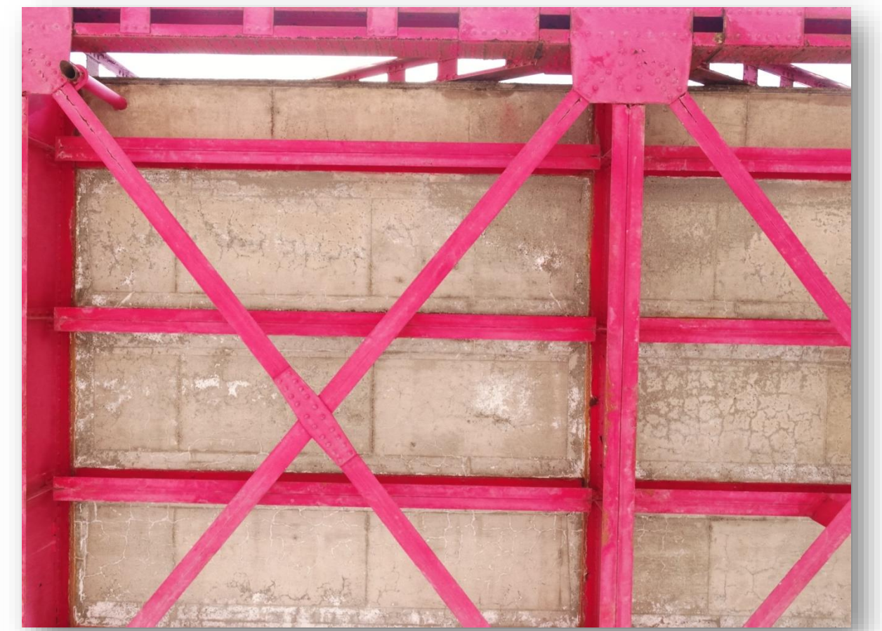
床版下面損傷状況
