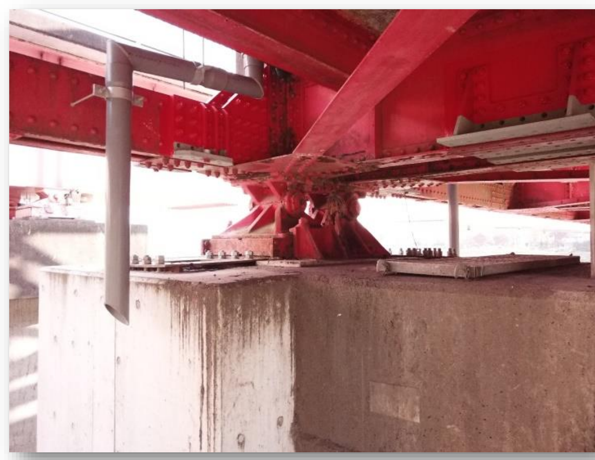
支承の機能障害状況（桁内）
